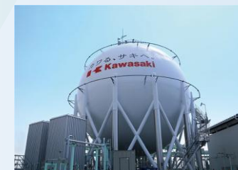
液化水素タンク
