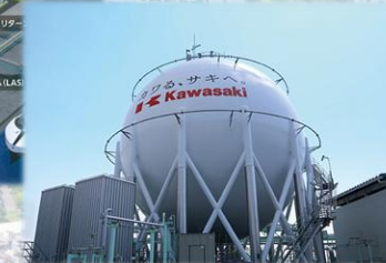
液化水素タンク
